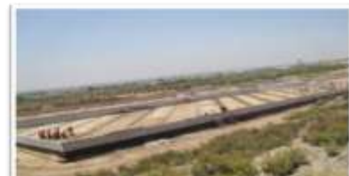
WWTP Sheikh Aijleen
